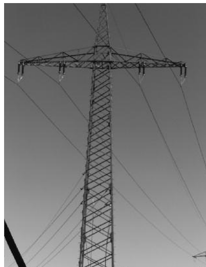
Freileitungsmast der Bahnstromleitung vor der Siedlung Ost
